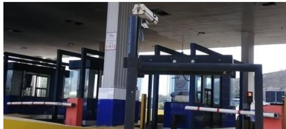
Figura 9-1: Equipos de operación.
