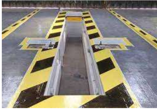
Figura 17-3: Foso de reparación
