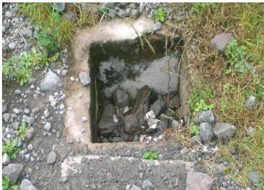
Fotografía 8. Desagüe de los efluentes líquidos.
