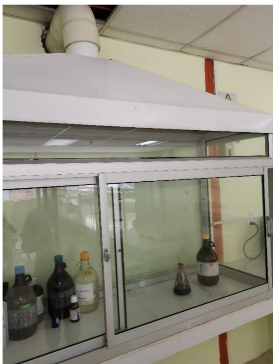
Figura 6C. Campana de extracción de gases.
