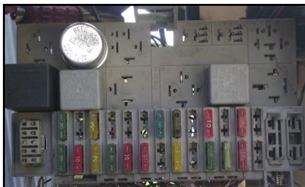
Figura 4.32: Disposición de los fusibles.
