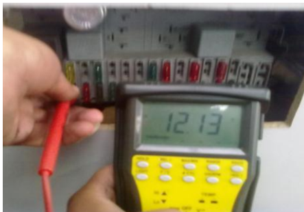
Figura 5.7: Comprobación con el voltímetro.
