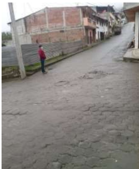
Figura 2-3: Condiciones de la infraestructura vial
