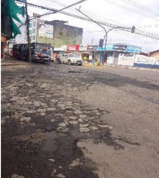
Fallas tipo bache y hundimiento de adoquines (Av. Quevedo y Abraham Calazacón)
