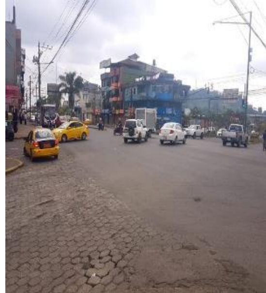
Fallas tipo bache y hundimiento de adoquines (Av. Chone y Abraham Calazacón)
