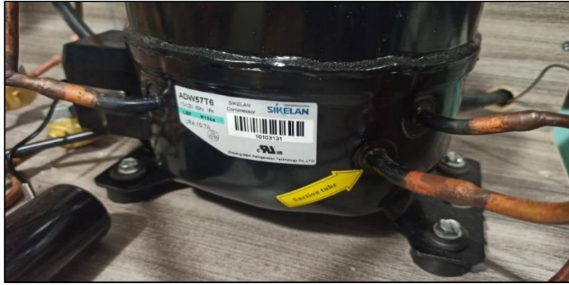
Figura 22-3: Compresor de 1/6 hp conectado al sistema
