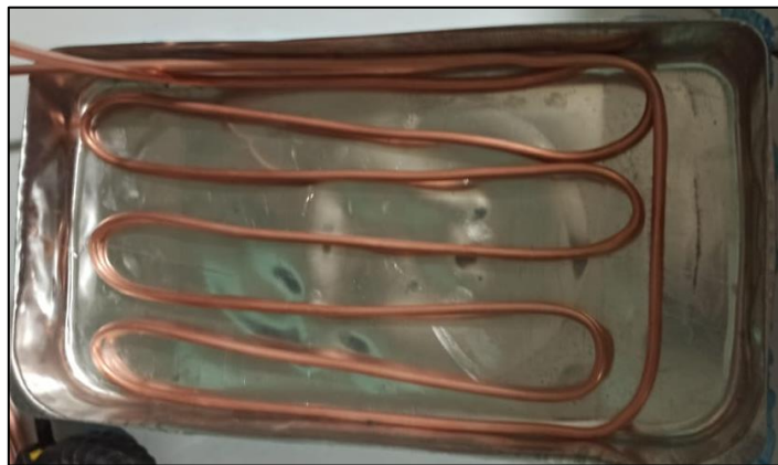
Figura 21-3: Bandeja de condensado e intercambiador de calor
