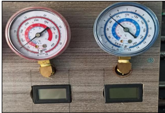
Figura 25-3: Manómetros de alta y baja y termómetros
