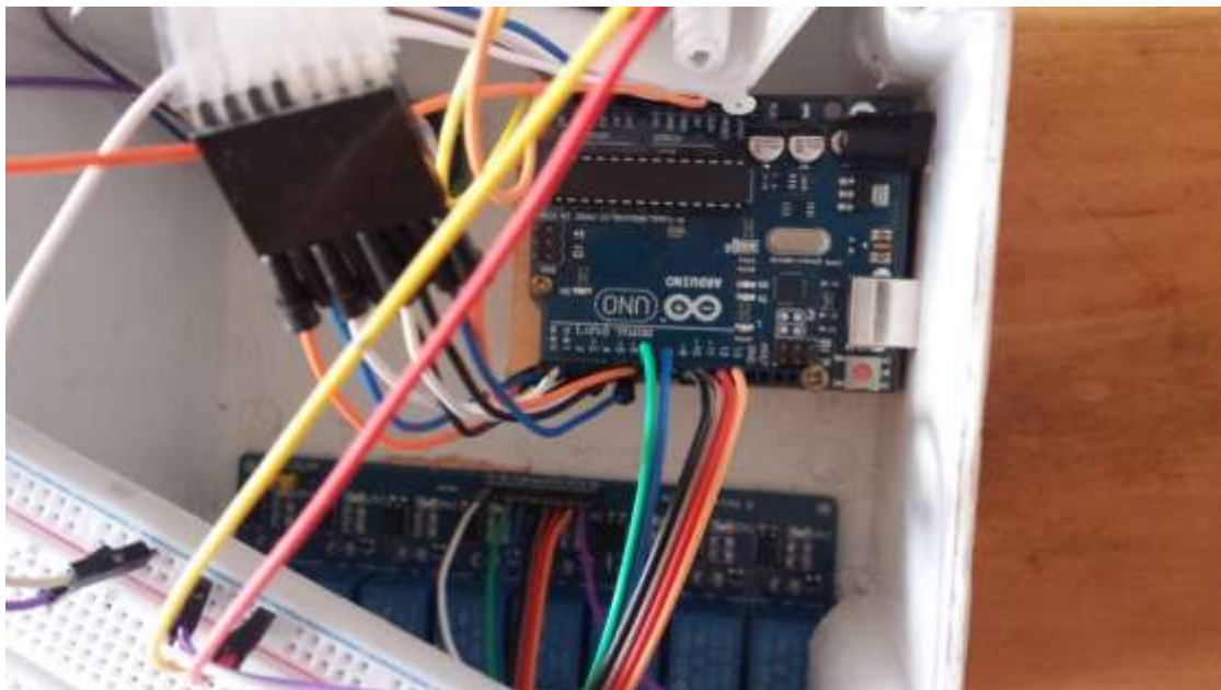
Figura 22-3: Vista interna del sistema de conexión
