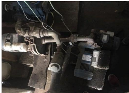
Figura 2-3. Instalación de sistema obsoleto.
