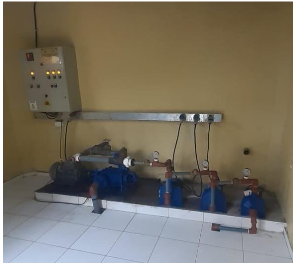
Gráfico 2. Cuarto de máquinas
