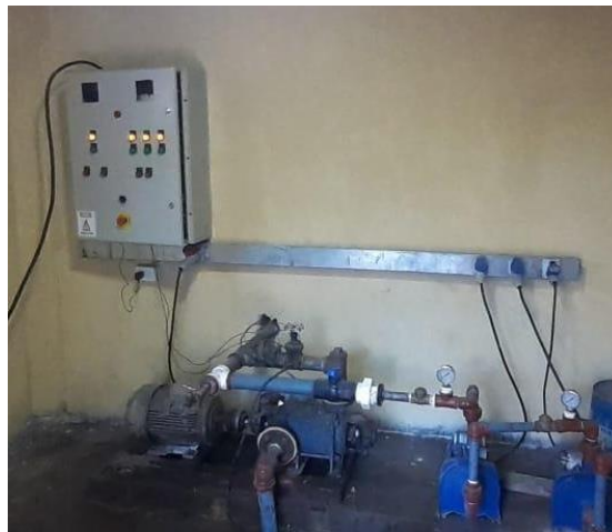
Figura 27-3. Cableado del sistema eléctrico.
