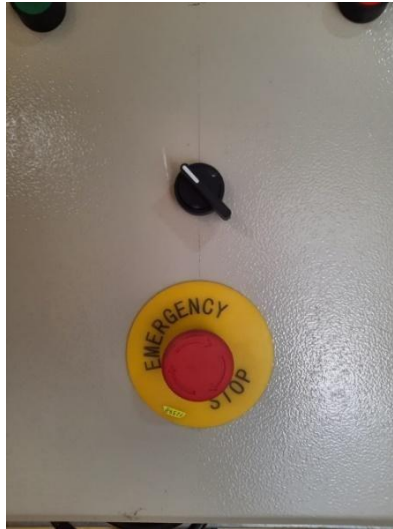
Figura 22-3. Paro de emergencia.
