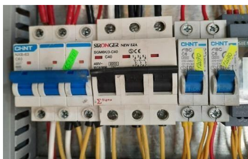
Figura 19-3. Disyuntores de protección.
