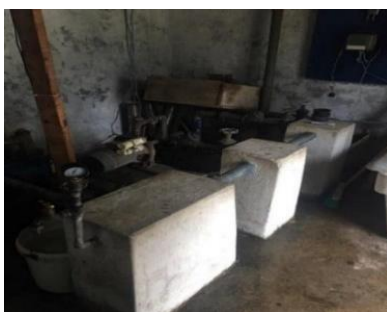
Figura 1-3. Sistema de bombeo.
