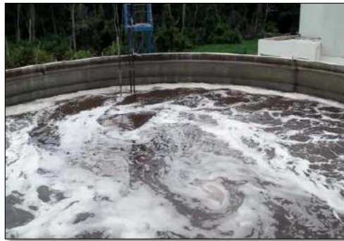
Figura 7-2: Tanque de homogenización
