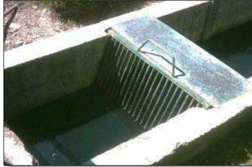
Figura 4-2: Sistema de rejillas de limpieza manual
