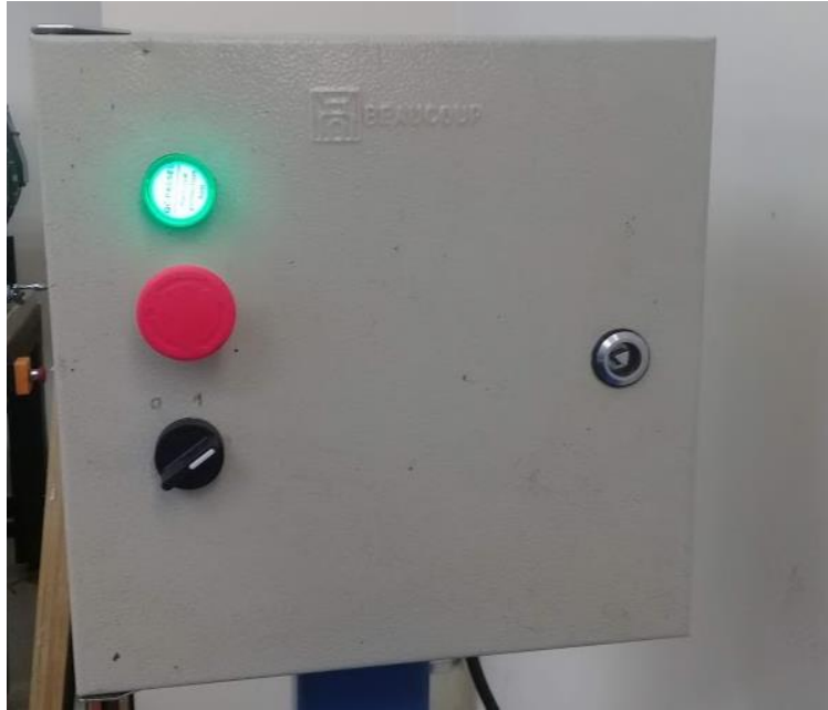
Figura 11-2: Tablero eléctrico Fuente: Autores
