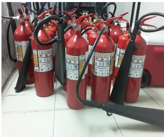
Figura 7-4: Extintores portátiles TRITON Realizado por: Ayuquina Laguna, Miryam, 2020
