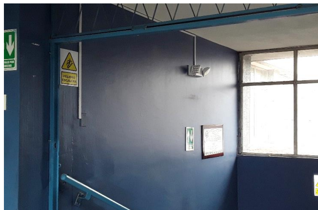
Figura 10-4: Instalación de la Lámpara de Emergencia
