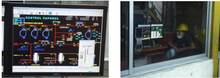
Figura 62: operadores de calderas
