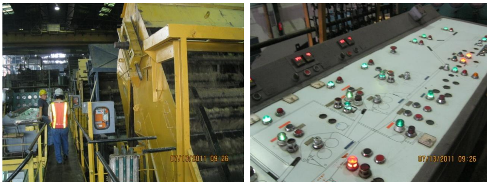
Figura 32: Operadores de tableros de control
