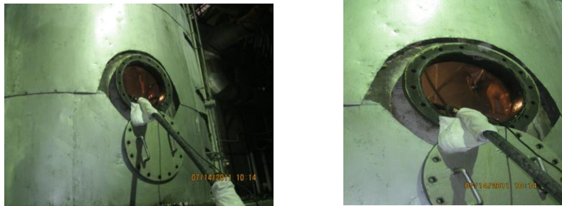
Figura 38: limpieza de evaporadores
