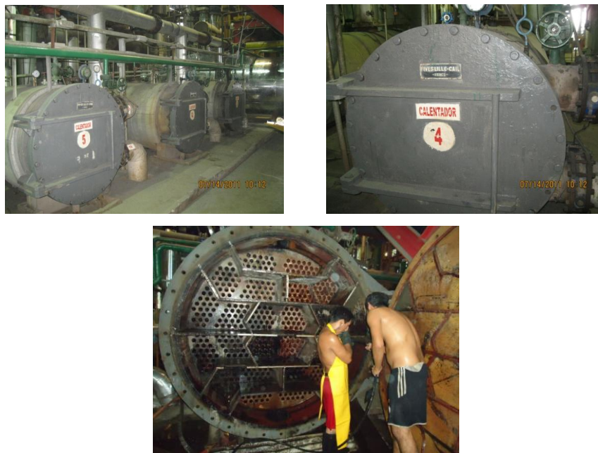
Figura 36: limpieza de calentadores
