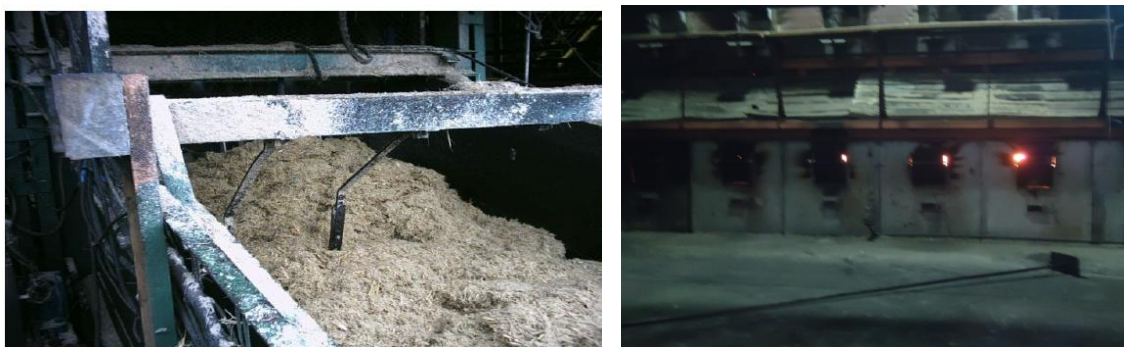
Figura 59: Área de calderas
