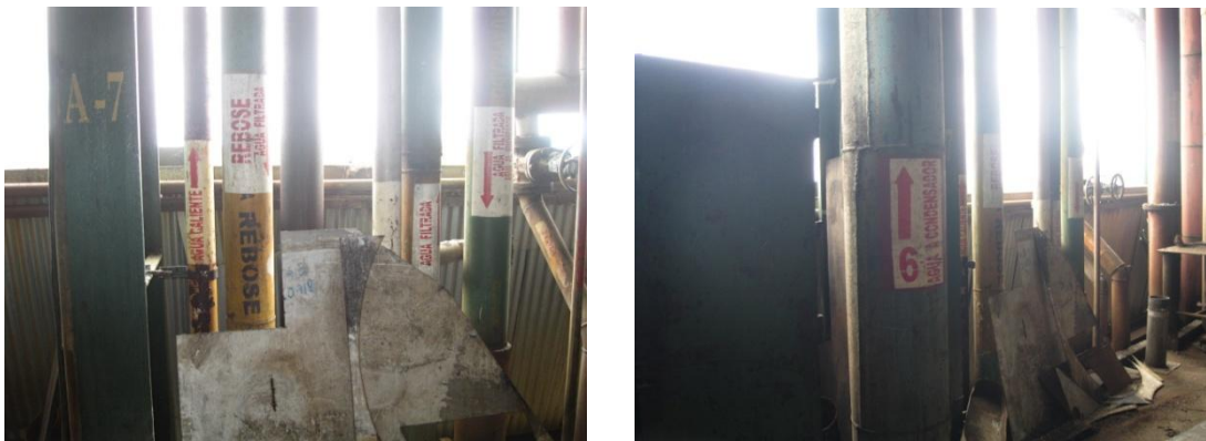
Figura 141: Señalización de tuberías y líneas de flujo
