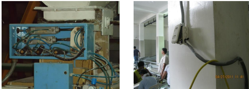
Figura 88: Instalaciones eléctricas defectuosas
