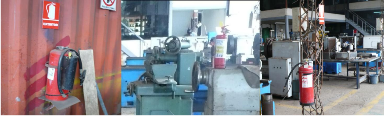
Figura 108: Extintores mal ubicados y en mal estado.
