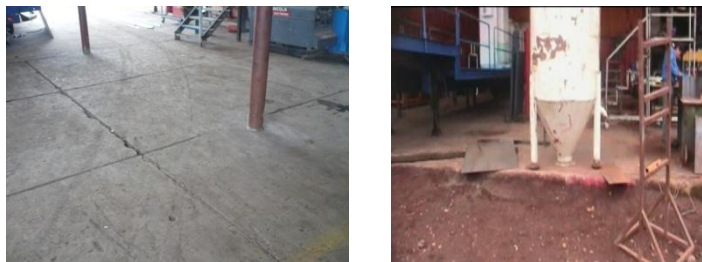
Figura 76: Piso irregular y con deficiente señalización.
