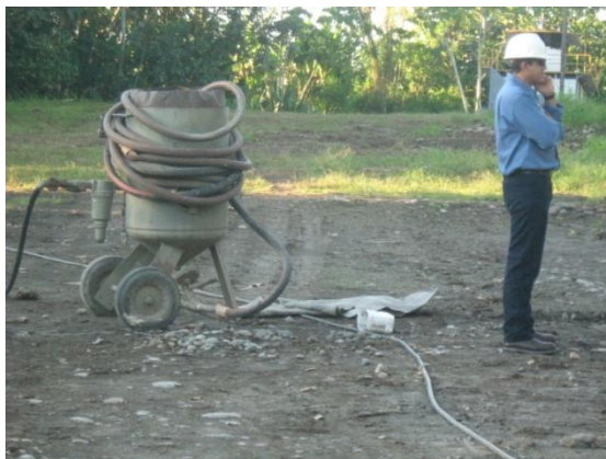
Figura 85: Piso irregular en el área de trabajo.
