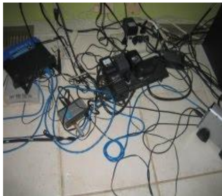
Figura 37: Obstáculos en el área de circulación peatonal.
