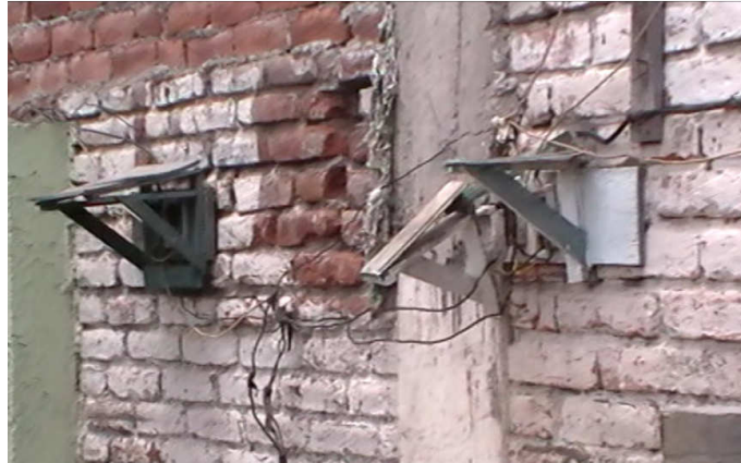
Figura 14 Instalaciones Eléctricas Deterioradas.
