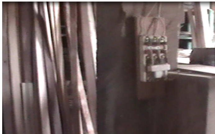
Figura 15 Proximidad de Material inflamable en Instalaciones.
