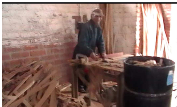
Figura 20 Operarios no Usan EPI
