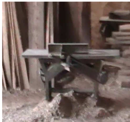
Figura 22 Máquinas sin protectores de banda.
