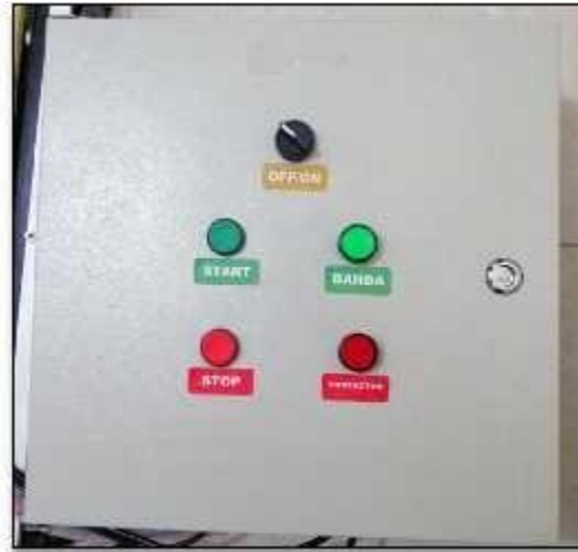
Figura 17-3: Tablero de control vista frontal Elaborado por: Palacios José y Velastegui Cristian, 2020
