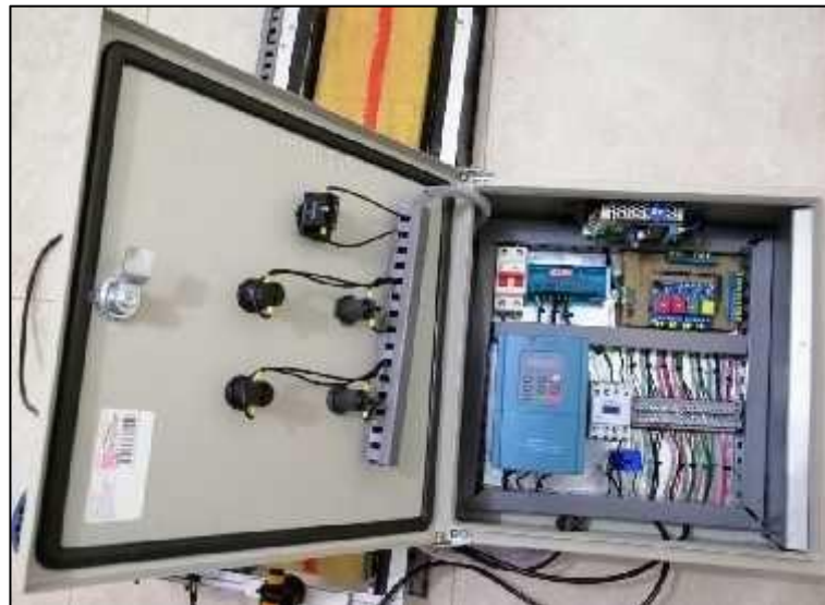
Figura 18-3: Parte interna terminada del Tablero de control Elaborado por: Palacios José y Velastegui Cristian, 2020
