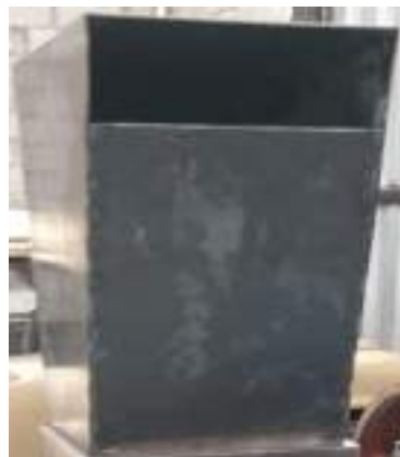
Figura 3-89: Tolva de entrada
