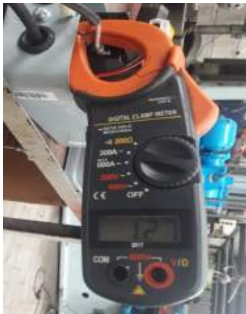
Figura 4-3: Amperaje en el motor.
