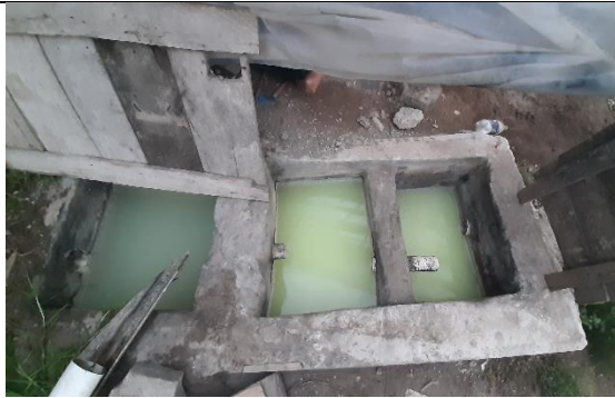
Fotografía 3: Tanques de salida del efluente
