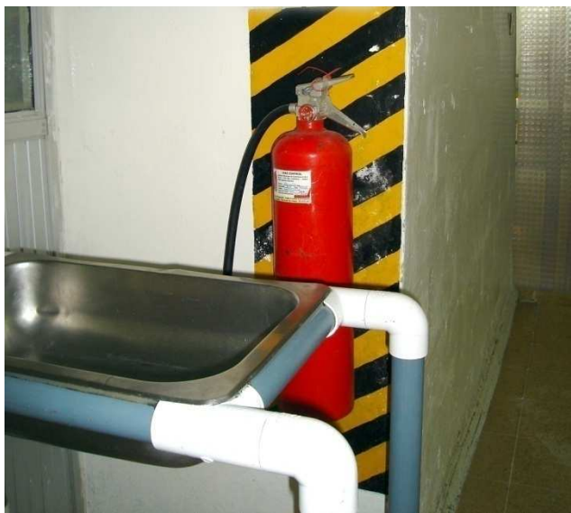
Fig. 101: Acceso a los extintores portátiles.
