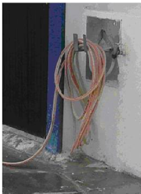
Fig. 100: Tomas de agua utilizada para limpieza.
