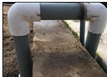
Figura 8-3. Tubería de succión del sistema por recirculación
