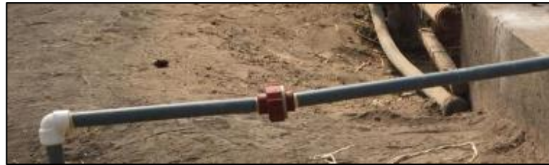
Figura 9-3. Tubería de descarga del sistema por recirculación
