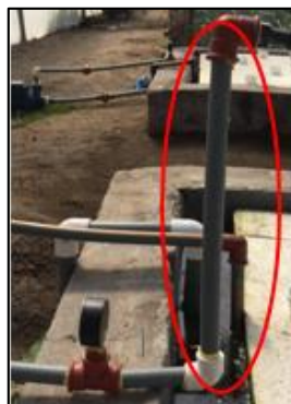
Figura 17-3. Tubería de descarga del sistema por gravedad
