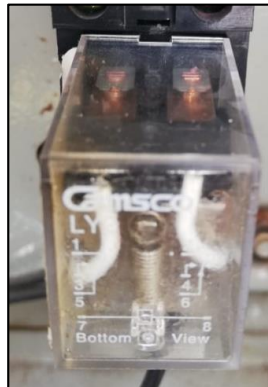
Figura 41-3. Relé del sistema de control
