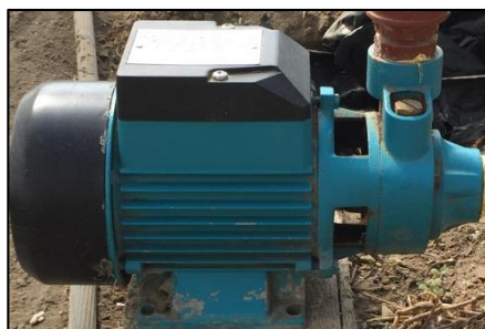
Figura 15-3. Bomba Centrífuga del sistema por gravedad
