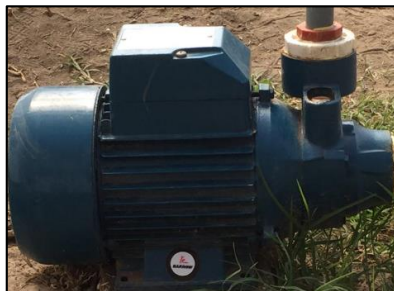
Figura 7-3. Bomba Centrífuga del sistema por recirculación
