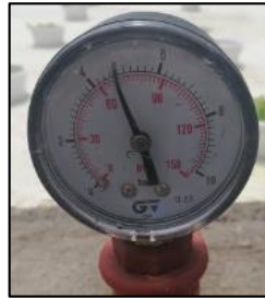
Figura 11-3. Manómetro del sistema por recirculación
