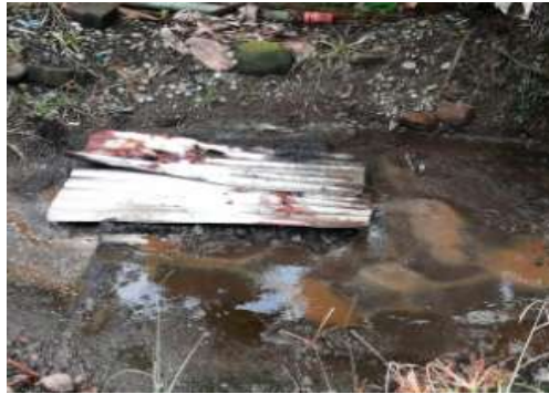
Figura 3-1. Pozo séptico de lixiviados colapsado.
