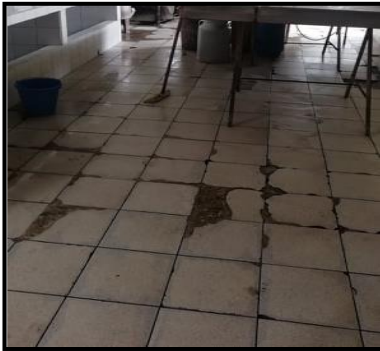
Imagen 1: Baldosa en mal estado dentro del área de producción
