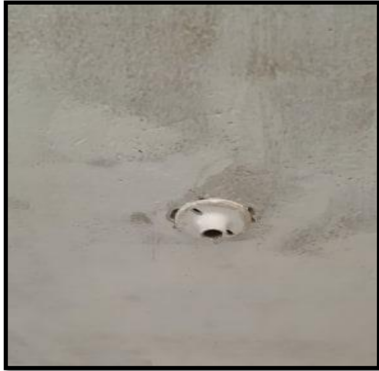
Imagen 13: No cuenta con iluminación adecuada dentro del área de producción.
