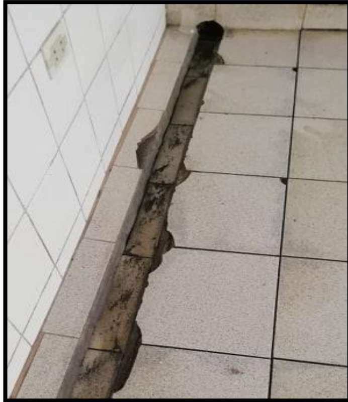
Imagen 9: Ausencia de protección para el drenaje.
