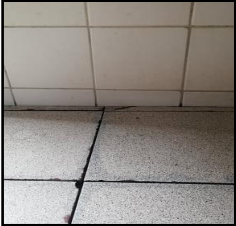
Imagen 5: No cuentan con zócalo de media caña.
