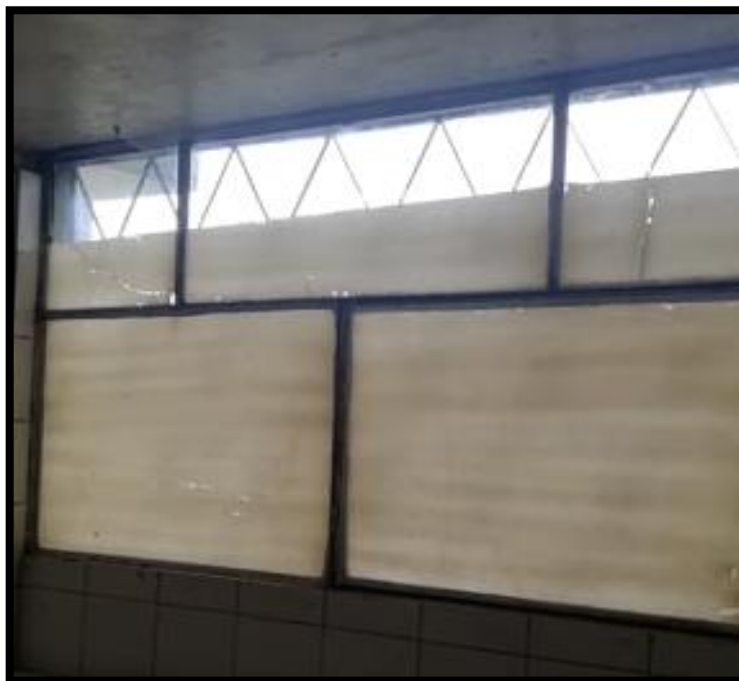
Imagen 2: Los vidrios de las ventanas trizadas en el área de producción
