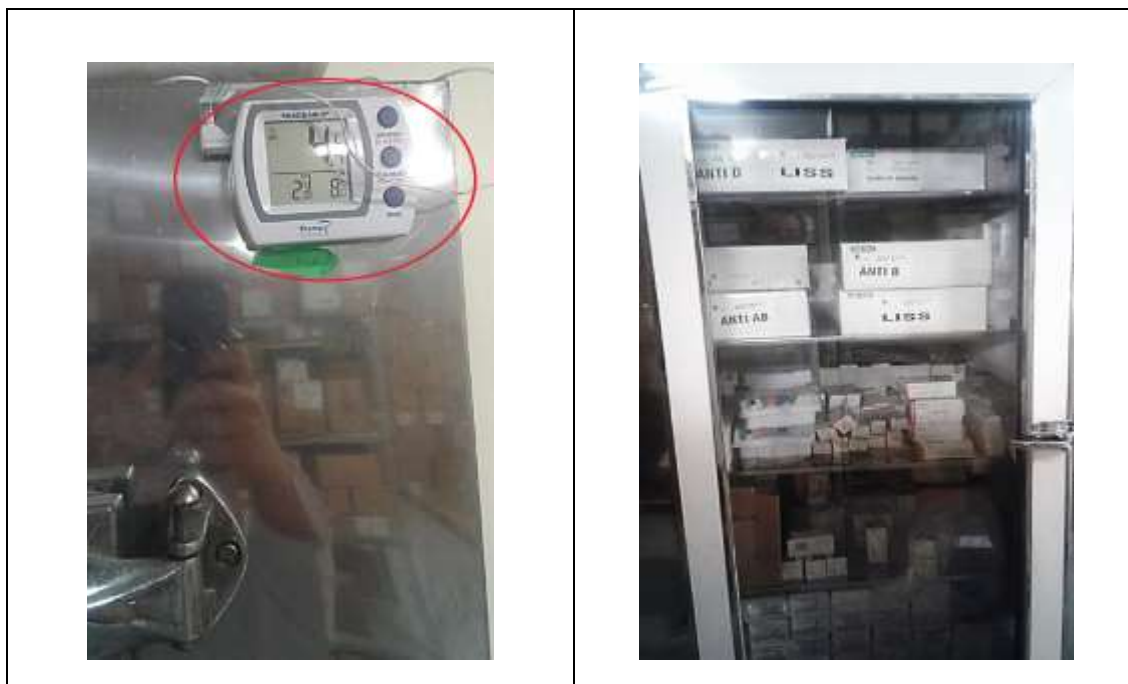
Figura 4-3: Cámara de refrigeración en donde los dispositivos médicos compartían con la de los medicamentos.
