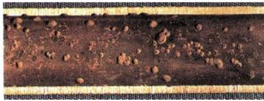
Figura 3.5 Picadura de un tubo por sulfato reductoras [24].
