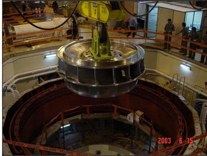
Figura 7. Rodete de la turbina Francis de la Central Agoyán.
