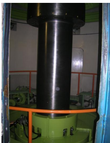
Figura 6. Eje de la unidad 1 de la turbina Francis de la Central Agoyán.
