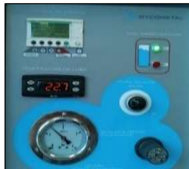
Figura 20-2. Tablero de control de la cámara
