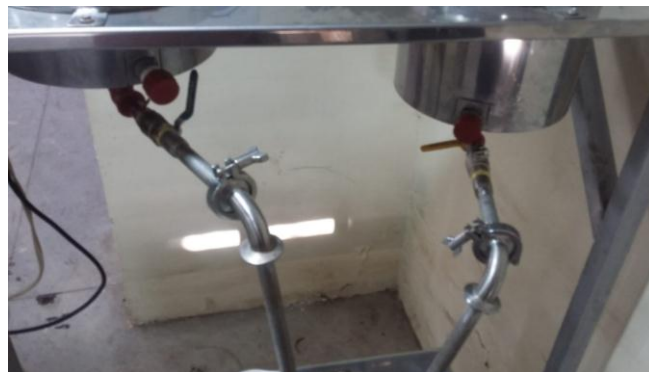
Figura 6-2. Llaves de paso de los tanques I y II.
