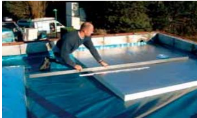
Figura 11-1. Planchas de poliuretano en cubiertas
