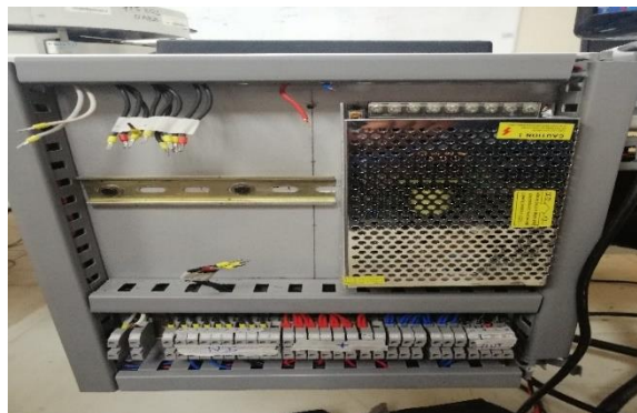
Figura 16-2: Tablero de control del sistema
