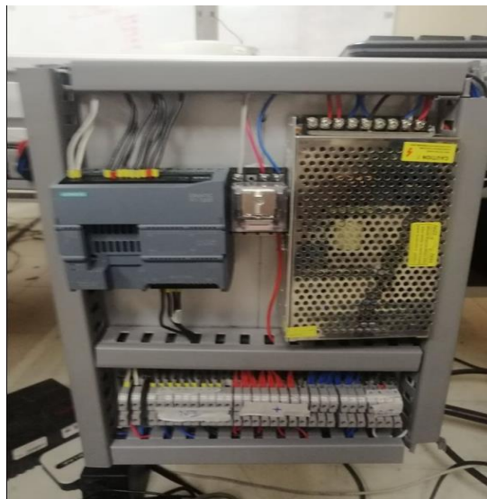
Figura 77-2: Tablero del Control
