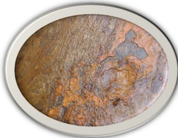
Figura 2.7: Estado actual punto de análisis tubería enterrada
