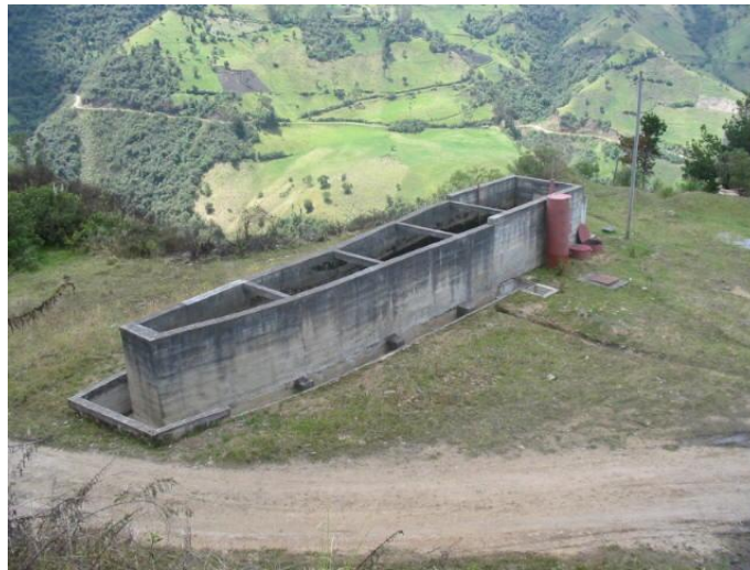
Figura 4.1: Tanque de Presión Central Hidroeléctrica Río Blanco
