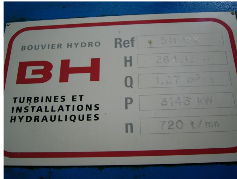
Figura 3.2: Datos de placa de la turbina Peltón
