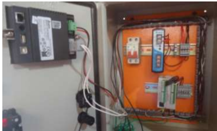
Figura 28 – 2: Conexiones de los componentes del tablero de control. Realizado por: CAISAGUANO, Washington, 2018
