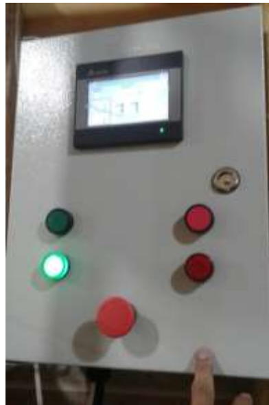
Figura 2 – 3: Puesta en marcha del tablero de control. Realizado por: CAISAGUANO, Washington, 2018
