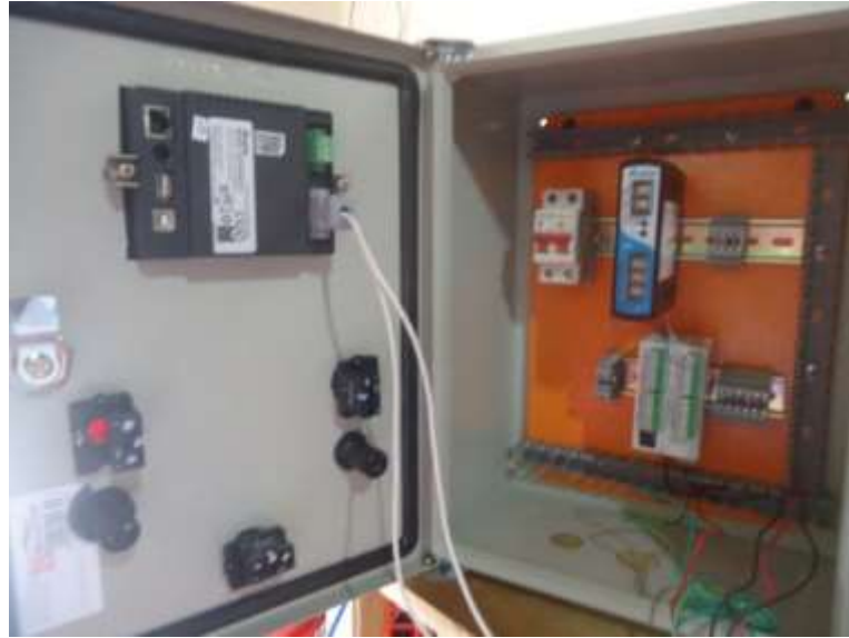
Figura 32 – 2: Ubicación de los dispositivos en el riel DIN. Realizado por: CAISAGUANO, Washington, 2018
