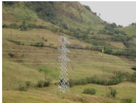
Imagen 8: torre de la línea de transmisión
