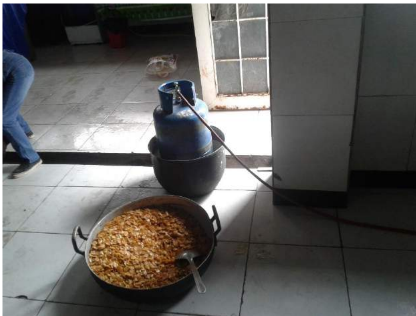
Figura 6-2. Tanques de gas en la Zona Húmeda de la Fábrica Indufrick
