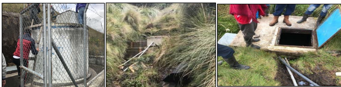
Figura 3- 1: Tanques de recolección de agua.
