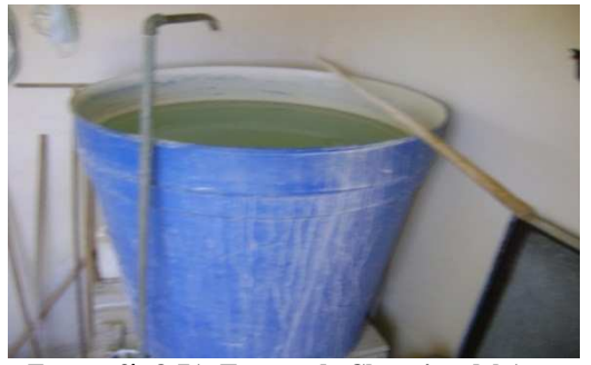
Fotografía 8-71: Tanque de Cloración del Agua
