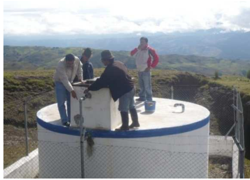
Fotografía 8-3: Tanque de Reserva
