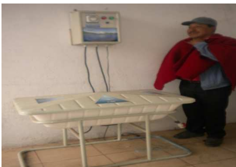
Fotografía 8-60: Equipo de Cloración para Tratamiento del Agua
