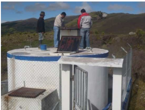
Fotografía 8-2: Tanque de Reserva
