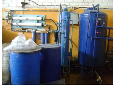
Figura 18: Tratamiento de agua 1.
