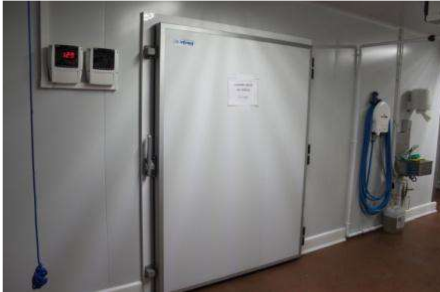
Figura 7: Cámara Frigorífica de alimentos.
