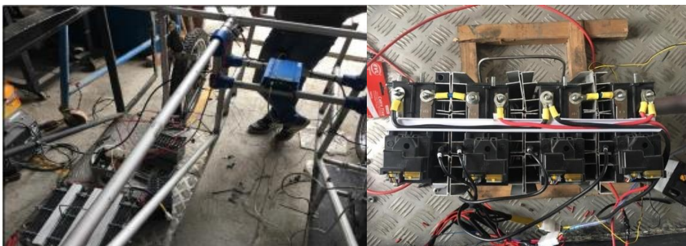
Figura 2-4: Conexión Baterías LiPO, Regulador Reductor de Voltaje
