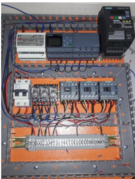
Figura 3-43: Cableado del tablero. Fuente: Autores, 2019.
