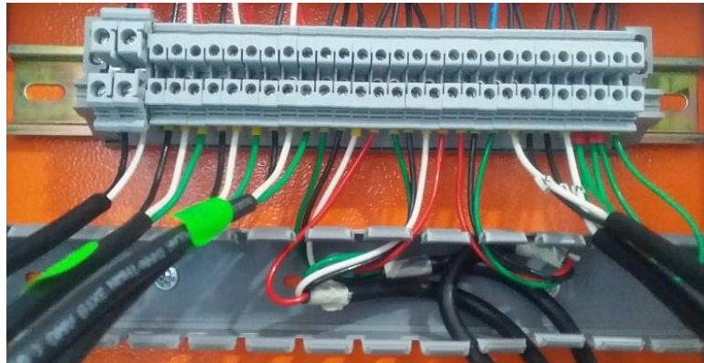
Figura 3-75: Conexión en la bornera del tablero de control. Fuente: Autores, 2019.
