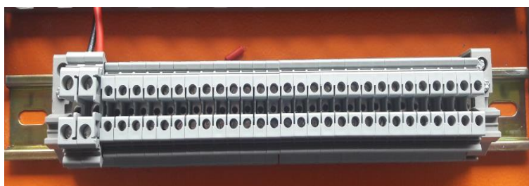
Figura 3-42: Ubicación de borneras en el perfil de soporte. Fuente: Autores, 2019.
