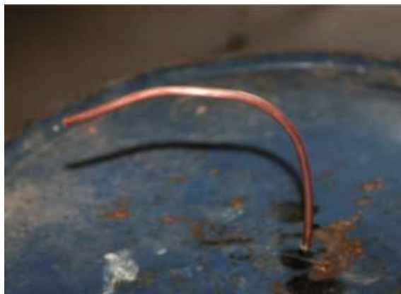
Figura 28-3: Desfogue del termo tanque. Fuente: Autores, 2019.
