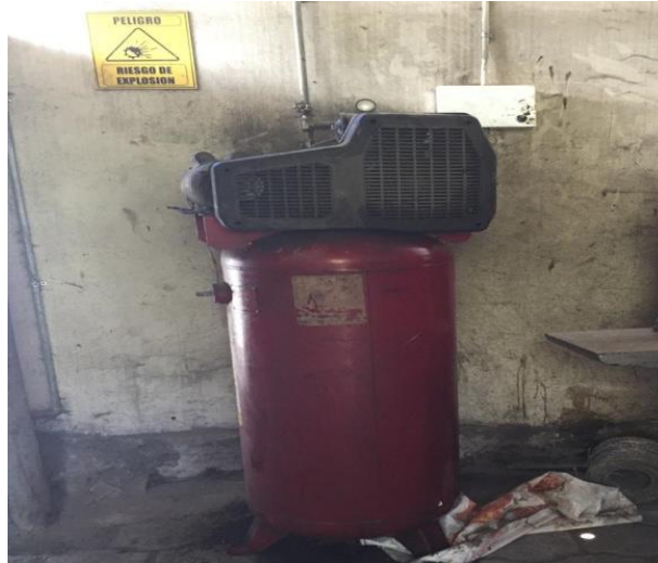
Figura 7-4. Instalación del aire comprimido Realizado por: Henry, Acaro; Marco, Terán, 2019
