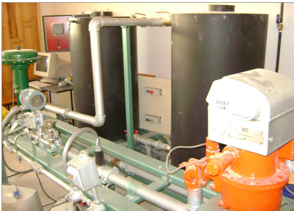
Figura 3.21 Sistema de Bombeo
