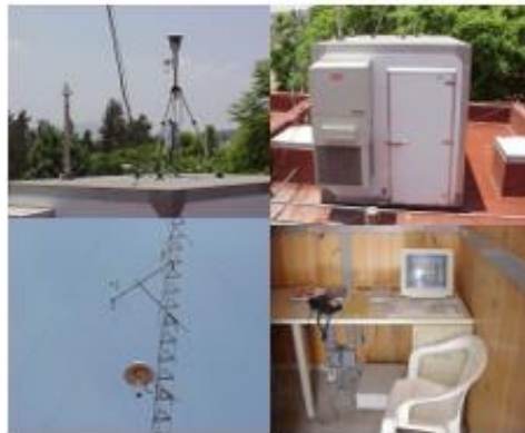
Figura 4-1: Estación automática para monitoreo de contaminantes criterio (PM10, CO, SO2, NO2, O3). Fuente: (Revista Scribd, 2017)
