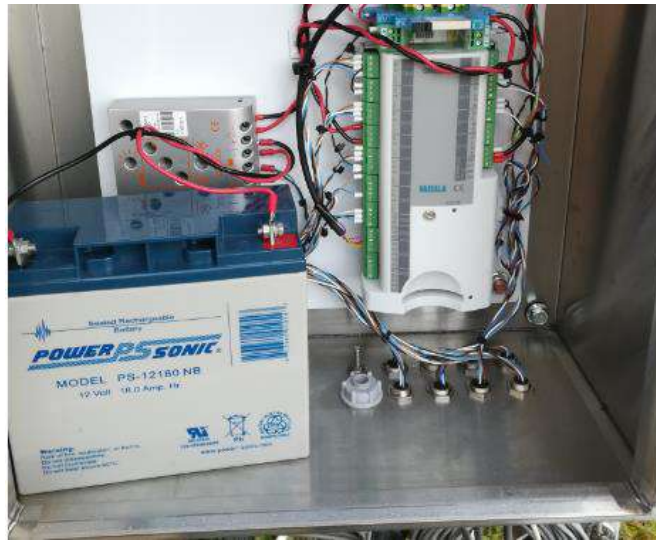
Figura 23-1: Datalogger y Batería al interior de Caja Nema
