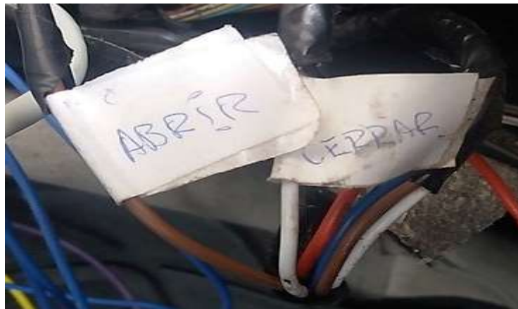
Figura 69-2: Cables de Entrada Funcionamiento de las puertas Realizado por: Tapuy, W. 2018
