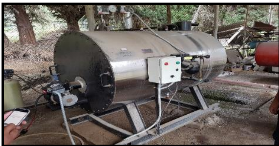
Figura 3-2 Estado actual de caldero
