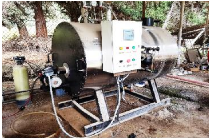
Figura 33-2 Tablero nuevo de control instalado Realizado por: Gavilanes A. 2018
