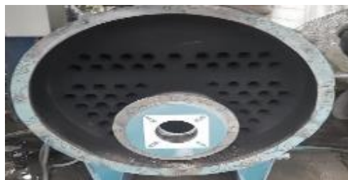
Figura 4-2 Registro de estado actual de caldero.
