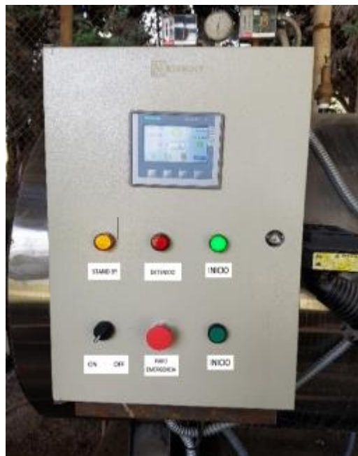
Figura 1-3 Tablero de Control Realizado por: Gavilanes A. 2018
