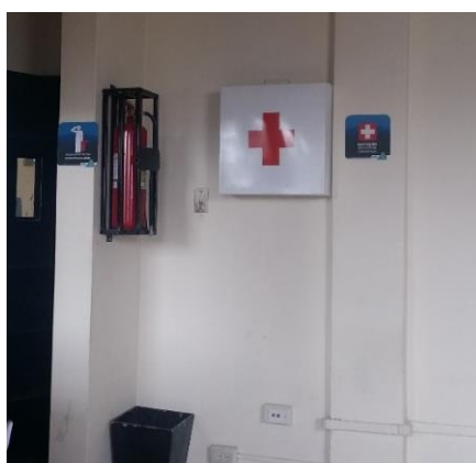
Figura 16-3. Ubicación de extintor y botiquín.
