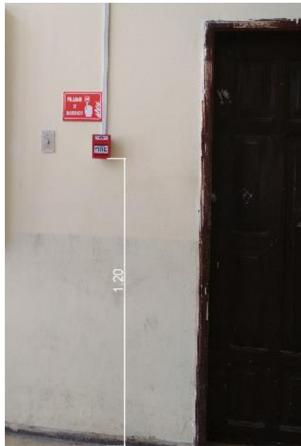
Figura 40-5. Pulsador de alarma de emergencia
