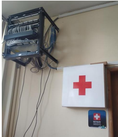
Figura 13-3. Botiquín a lado de un riesgo eléctrico, sin señalética de seguridad.
