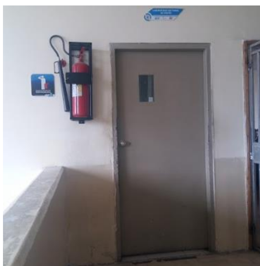
Figura 15-3. Extintor con difícil acceso
