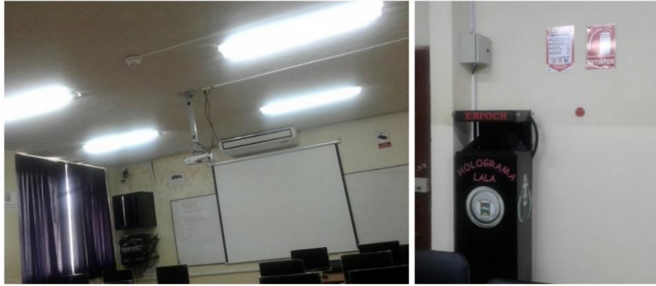
Figura 19-3: Laboratorio de computación I sin extintor portátil/MI/PA
