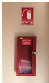
Figura 30-3: Gabinetes sin extintor portátil /PB/MIII/E.I.I.
