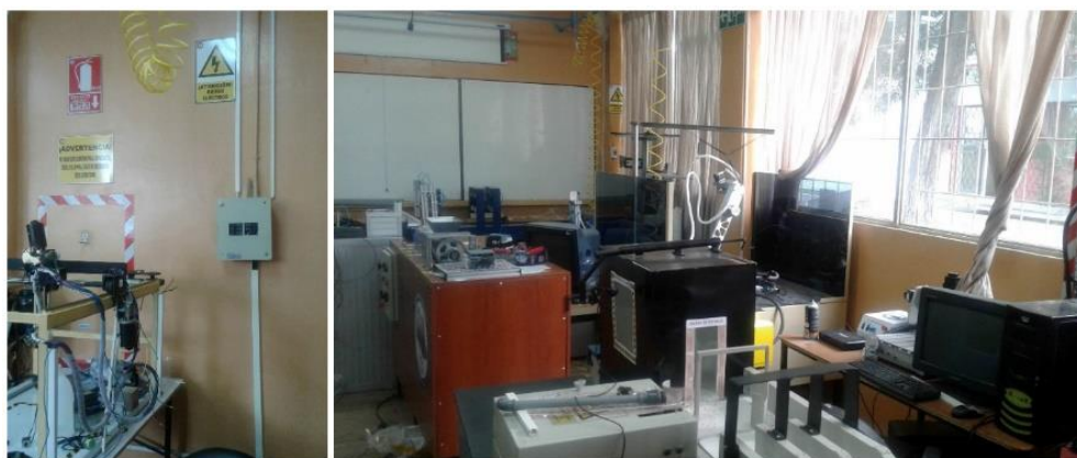
Figura 8-3: Extintores vencidos y obstruidos/obstrucción vías de evac. /Taller AP. /MI/PB
