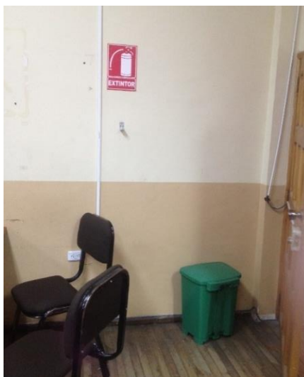
Figura 5-3: Extintor en un lugar inadecuado/Lab. Comp. /MI/PB
