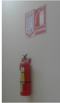
Figura 13-3: Extintor portátil vencido/PA/MI/E.I.I.
