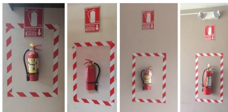
Figura 34-3: Extintores portátiles vencidos/Biblioteca FM ESPOCH/E.I.I.
