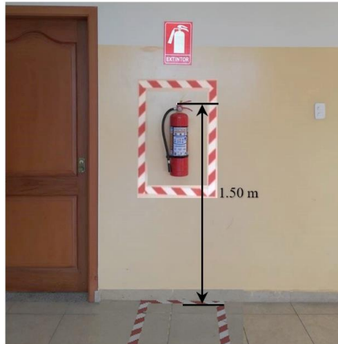
Figura 10-5: Extintor PQS de 10lbs, Según Regl. de Prev, Mit. y Prot Contra Incendio. Realizado por: David Zambrano, 2018
