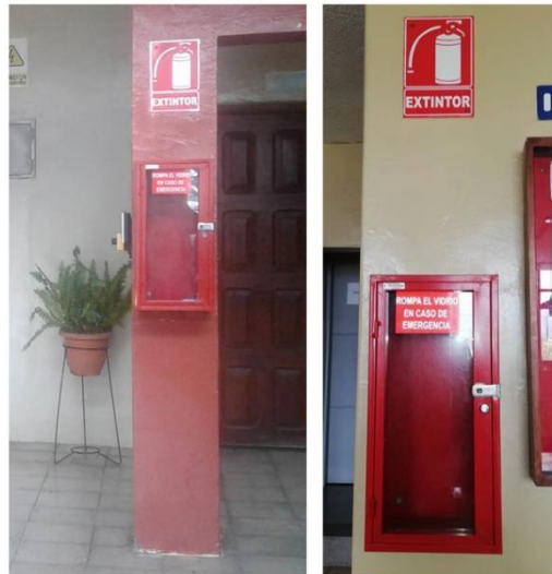
Figura 21-3: Gabinetes sin extintores portátiles /PB/PA/MI/E.I.I.
