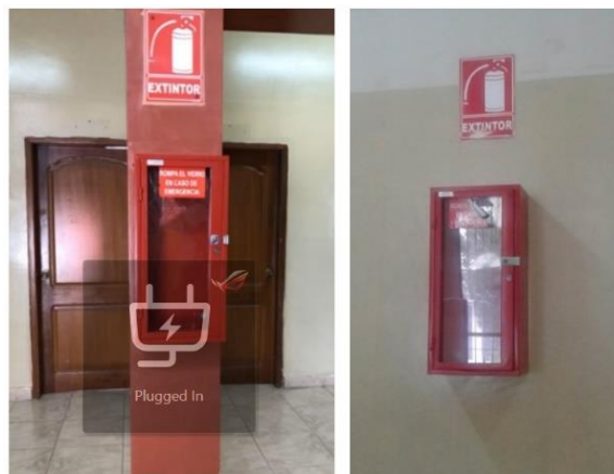
Figura 25-3: Gabinetes sin extintores portátiles /PB/PA/MII/E.I.I.
