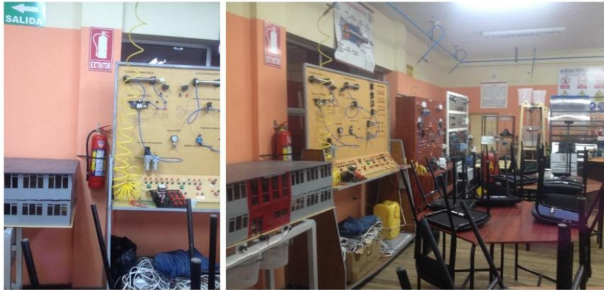
Figura 7-3: Extintor vencido y obstruido/obstáculos de vías de evac. /TallerSNH. /MI/PB
