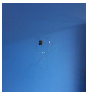
Figura 13-3. Caja de breakers
